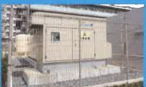
自家発電設備
